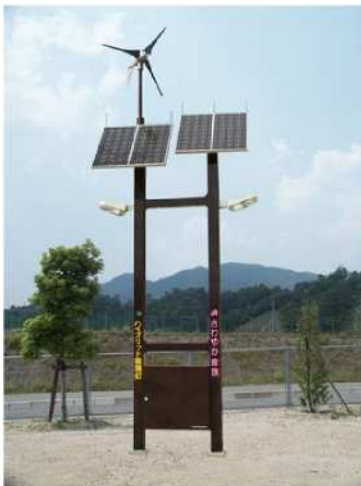
ハイブリッド街路灯 (さわやか家族) 特長 太陽光と風力を電気に変え 避難誘導灯として活躍しています。
